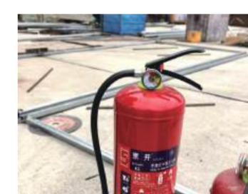
整改前灭火器失效
