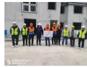
吊篮挂牌验收后再使用
