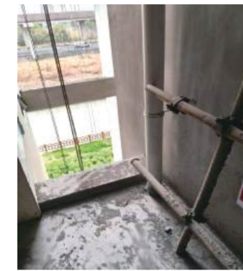
整改前临边防护移位未及时恢复
